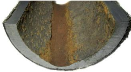
Şəkil 4. 894 sutka istismardan sonra Ø114x12mm borunun metalının korroziya dağılması
