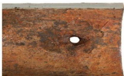
Şəkil 5. 66 sutka istismardan sonra Ø 73x5,5 mm borunun metalının korroziya dağılması
