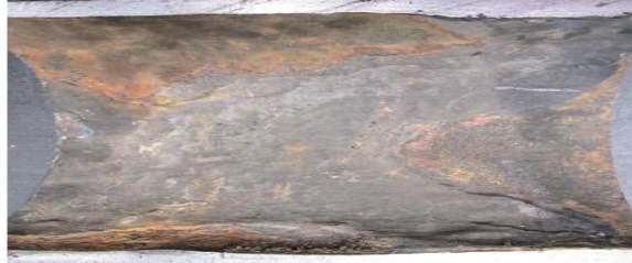
Şəkil 3. 1316 sutka istismardan sonra Ø219x18mm borunun metalının korroziya dağılması
